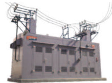
Пункты автоматического регулирования напряжения
