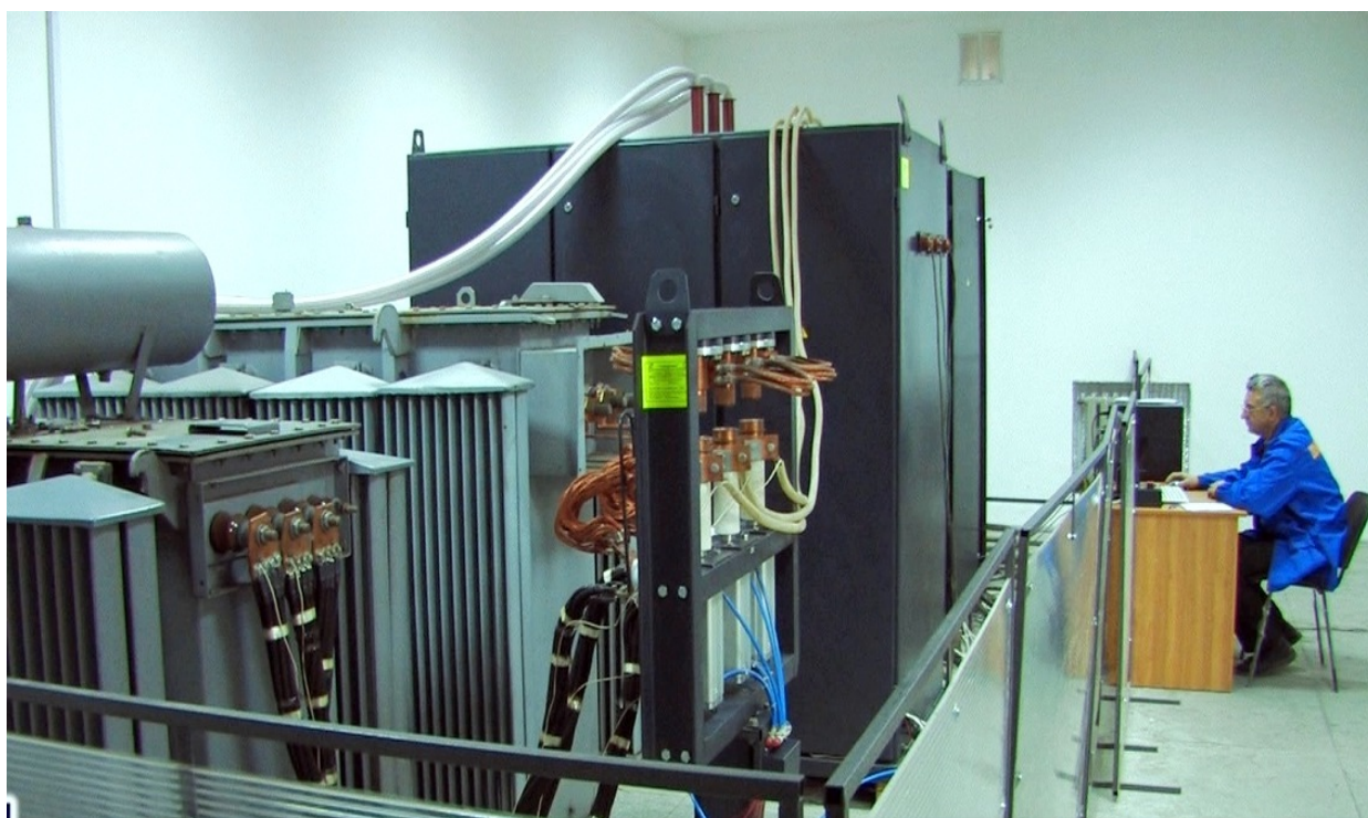
Рис. 1 – Общий вид станции автоматизированной для испытания силовых трансформаторов I-IV габаритов мощностью до 2000 кВА ЦАЕИ 02.01.13А
